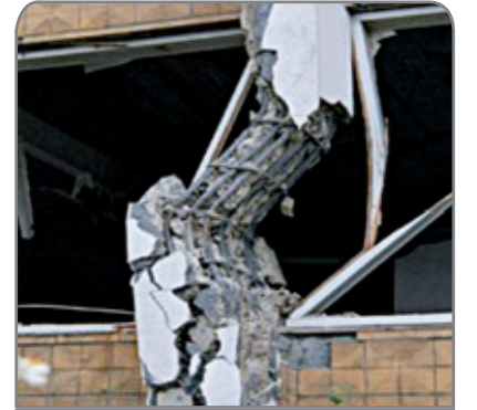
Şekil 38. Kısa kolon hasarı
