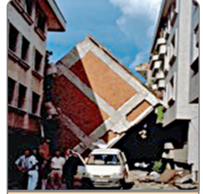
Şekil 20. Hatalı temel tasarımı olan bir yapının deprem davranışı
