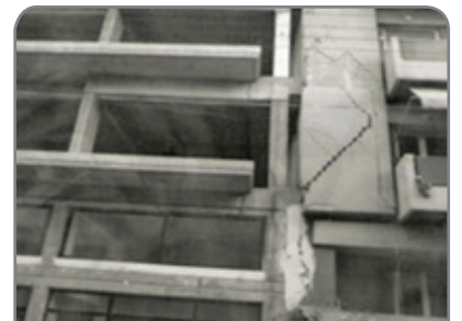
Şekil 35. Bitişik binaların etkileşimi sonucu oluşan hasar
