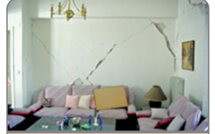
Şekil 31. Dolgu duvarlarda meydana gelen tipik hasar
