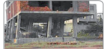
Şekil 28. Yumuşak kat oluşumu sonucu meydana gelen hasar, 1999 Kocaeli/İzmit
